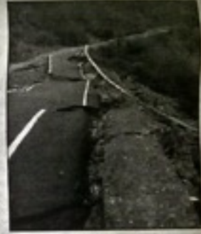
La frana sulla strada provinciale 153
